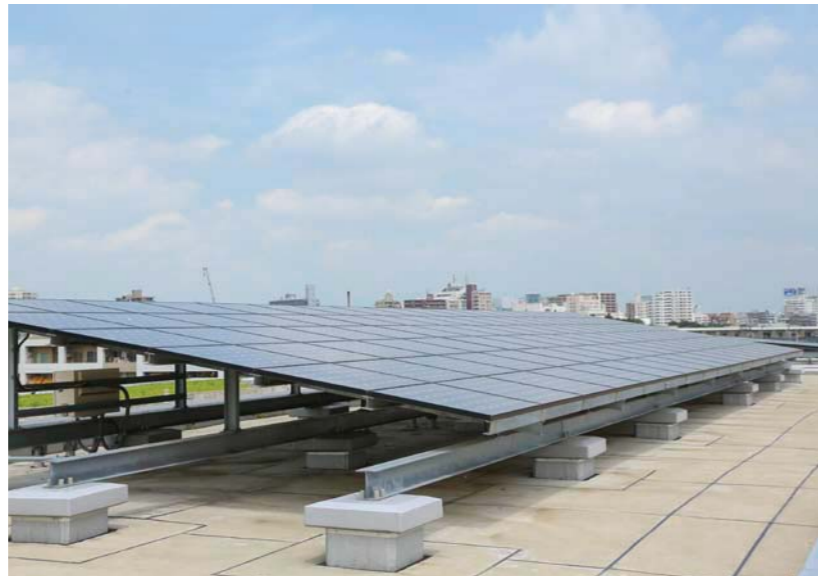
シャレール荻窪の屋上に設置した太陽光発電パネル(共用部用)。専有部用の太陽光発電パネルも共用部用とは別に設置している
