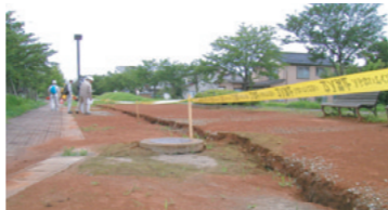
地割れの起きた公園
