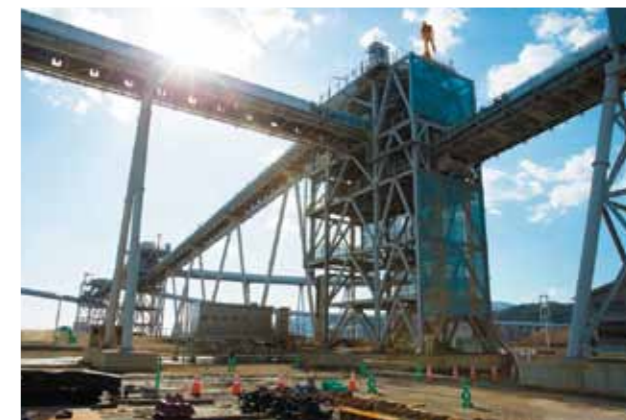
上部をチューブ状にカバーしたベルトコンベヤー。工期短縮や安全に貢献する。
