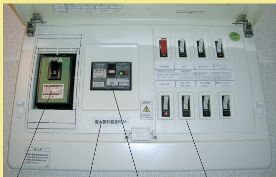
电流限制器 最大可契约电容量 漏电断路器 配线用断路器
